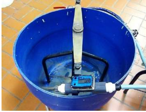
Figura 5.20. Medidor de fluxo instalado no dispositivo de resfriamento.
