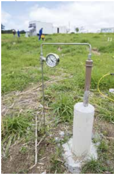
Poço de injeção de CO 2
