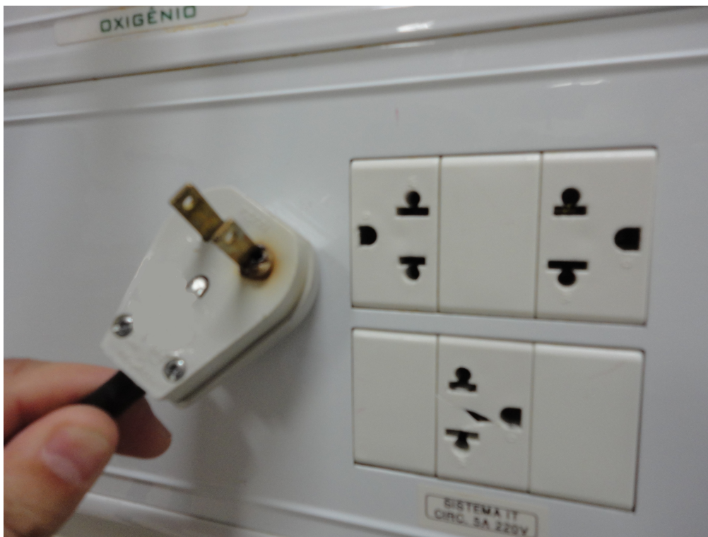
B.2 – Plugue de EEM com pino de aterramento cortado. Além disso um dos pinos está esquentando e causando deterioração do plástico do plugue. Normalmente isto é provocado por mau contato do pino com o condutor dentro do plugue.
