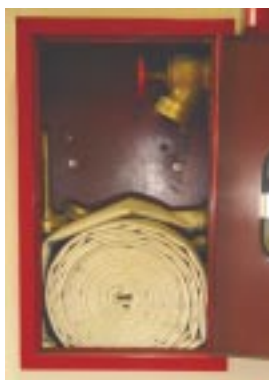
Sistema de hidrantes
