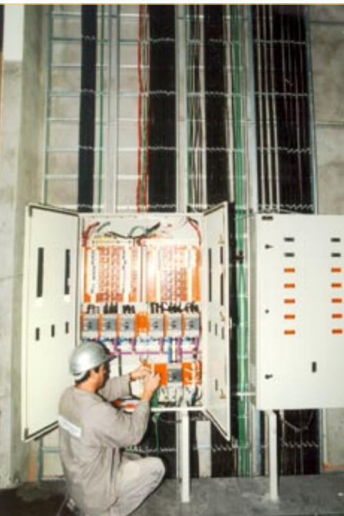
Rede elétrica: Centro de distribuição de energia
