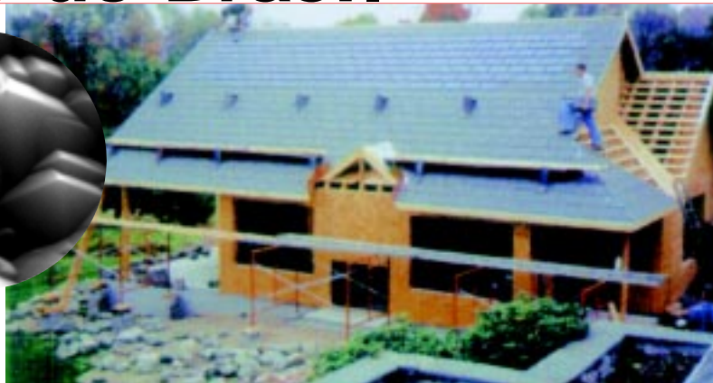
Telhado abriga células fotovoltaicas
