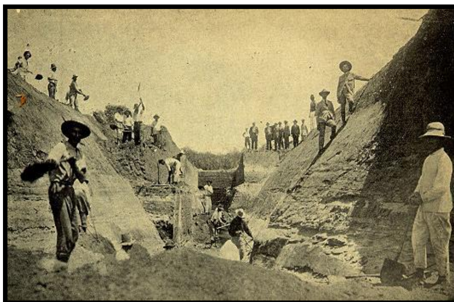
Figura 25: Escavação para o assentamento das linhas de aspiração da água do Rio Jacuí, a fim de ser recalçada para os filtros - Cachoeira.
