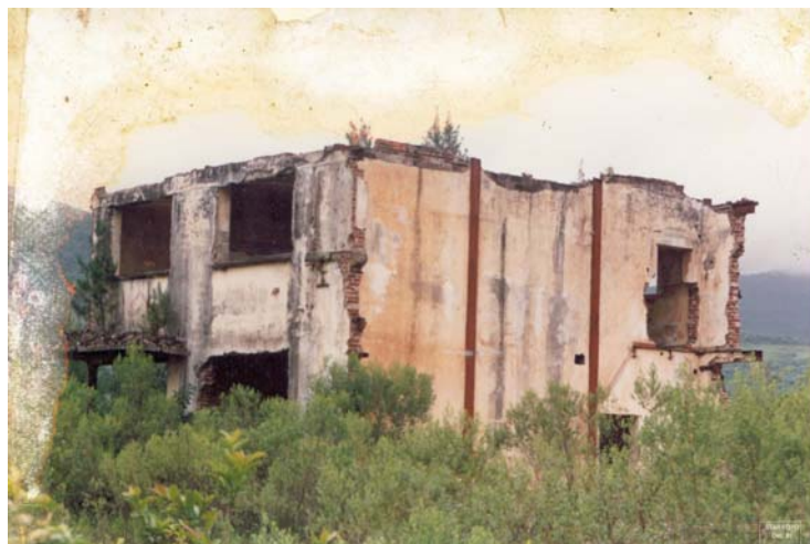
Fotografia 19 – Prédio da Destilaria Livramento em ruínas – década de 1980
