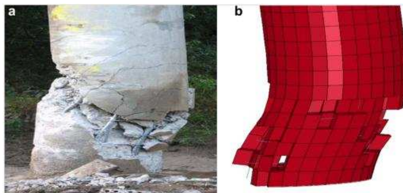
Figura 3.5. Validação da colisão de um caminhão com a coluna de uma ponte de IH-20, longview, Texas. (a) Coluna de concreto armado depois da colisão com o veículo. (b) Simulação do evento de colisão (Sharma et. al. 2012).
