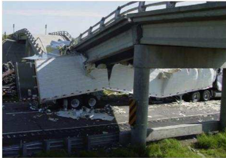
Figura 3.3. Colapso da ponte em I-80 em Nebraska depois da colisão de um caminhão (Sharma, Hurlebaus e Gardoni, 2012).
