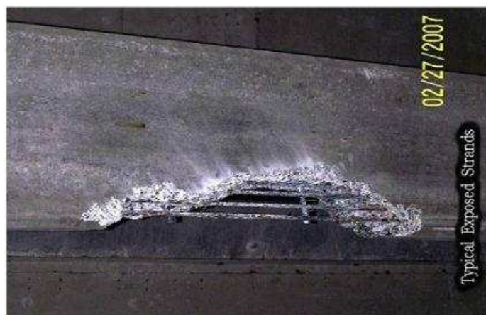
Figura 3.2. Danos em uma viga de concreto submetida a impacto causado pela colisão de um veículo pesado (Yang e Qiao, 2010).
