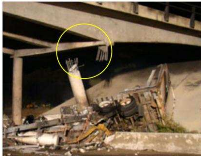
Figura 3.1. Danos em uma coluna de concreto submetida a impacto causado pela colisão de um veículo (Thilakarathna et. al., 2010).
