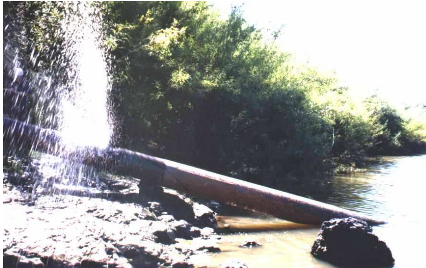
Figura 5.8. Canalização Apresentando Perfurações. Fonte: Relatórios Energéticos Produzidos pelo GEE.
