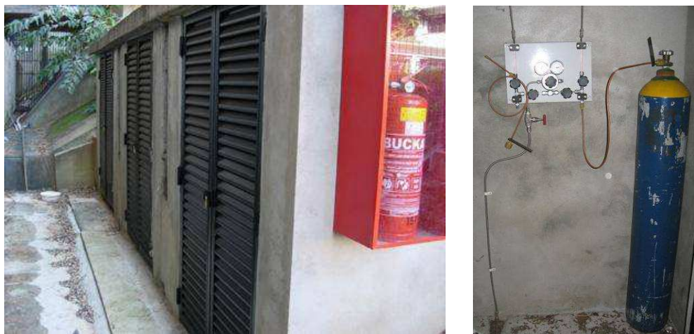
Fig. 7.2 Acomodações dos cilindros de gases
