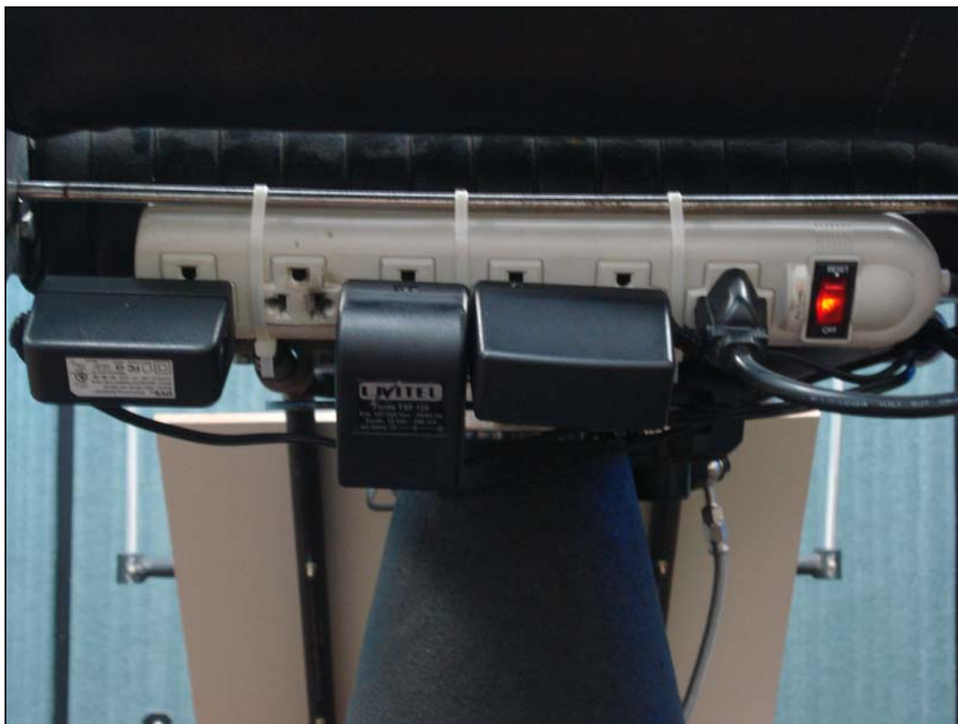
Figura 142 - Régua de distribuição de energia elétrica com periféricos: detalhe da régua fixada por amarras de plástico na parte posterior da CREC-Ap com os diversos conversores conectados.
