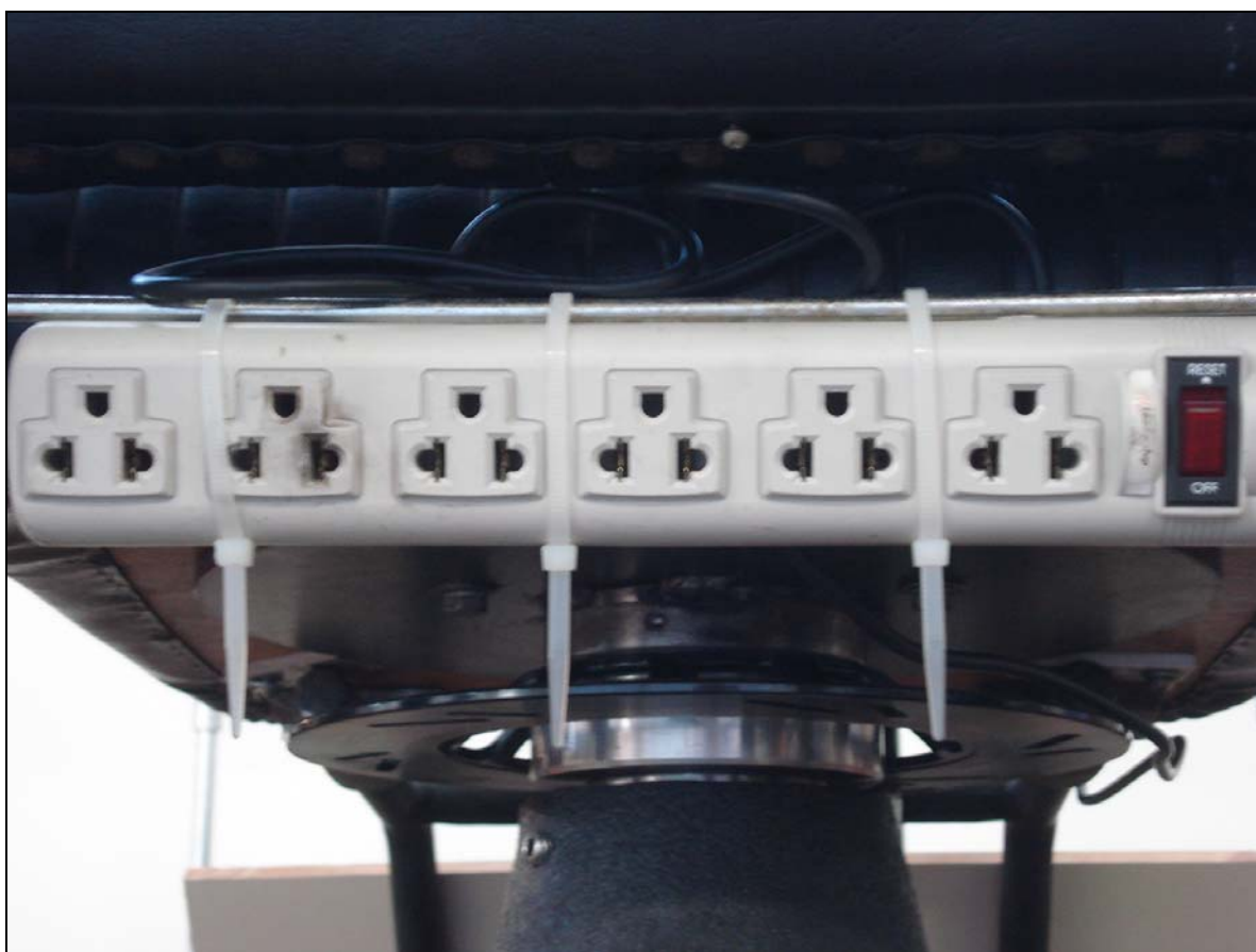
Figura 124 - Fixação da régua de distribuição de energia elétrica: detalhe da régua fixada por amarras de plástico na parte posterior da CREC-Ap. Fonte: O autor (2007).
