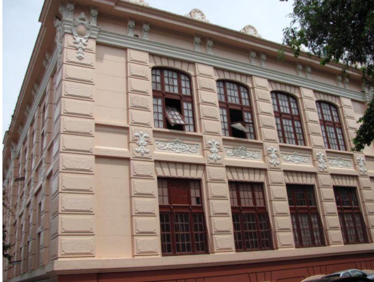
Figura 19: Detalhe das janelas do primeiro e segundo pavimentos em uma das laterais do prédio (Fonte: Arquivo particular, 2010)
