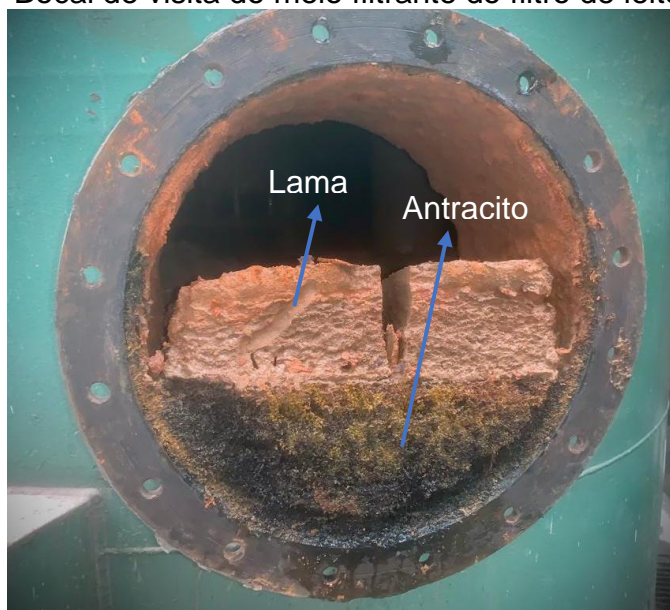
Figura 10 – Bocal de visita do meio filtrante do filtro de leito granular 2.
