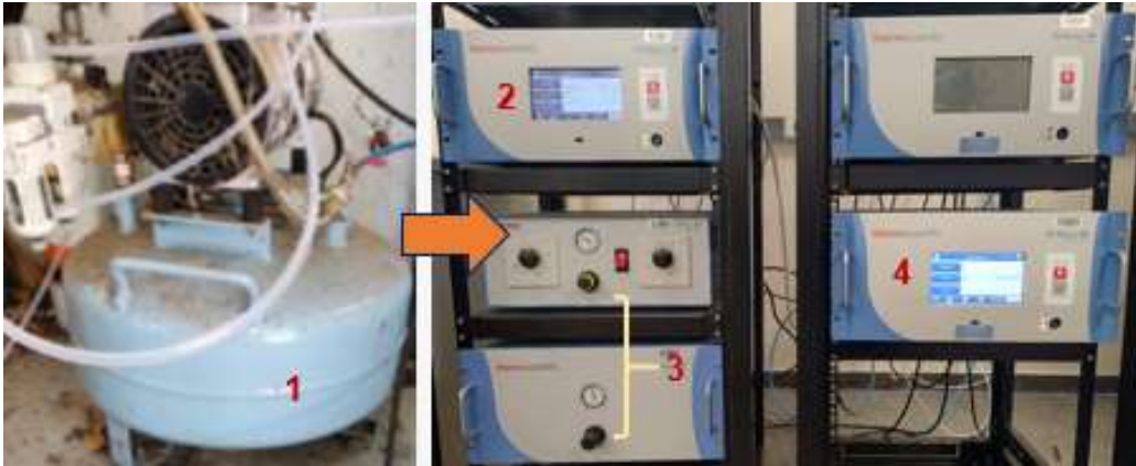
Figura 2: 1) Compressor onde passa o ar ambiente; 2) Multicalibrador (IQ 146) onde transforma em ar zero o ar ambiente; 3) A remoção de contaminantes (IQ 111); 4) Analisador de ozônio (IQ 49) onde capta os dados do Multicalibrador.
