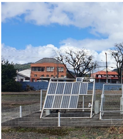
Figura 18: Estação de monitoramento.
