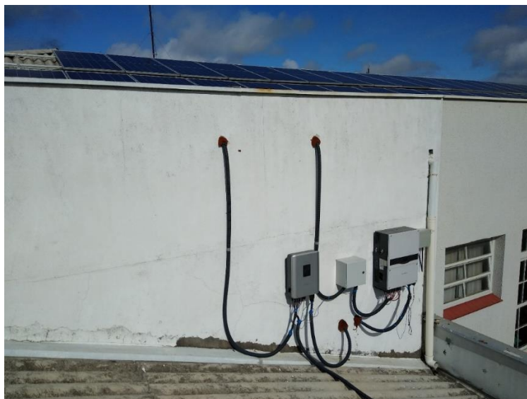
Figura 26: Localização do arranjo G4 bem como do inversor e quadros de proteção CA e CC.
