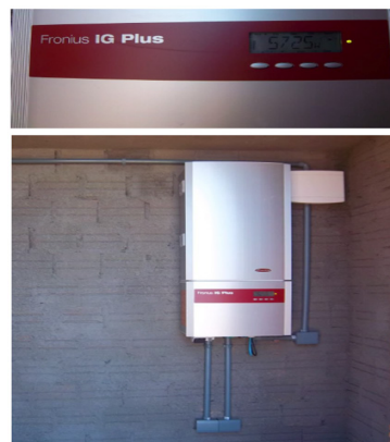
FIGURA 16. Sistema solar fotovoltaico – Mostardas.
