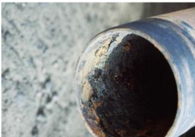
Figura 3.2. Corrosão em presença de oxigênio causada em tubulação. Fonte: Popoola et al. (2013).
