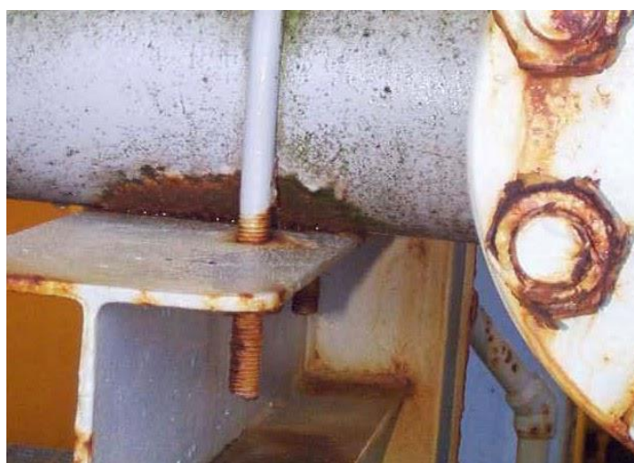
Figura 3.4. Corrosão em fresta em suportes de tubulação. Fonte: Inspeção de Equipamentos (2018).
