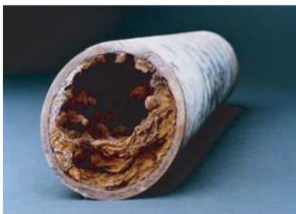
Figura 3.5. Corrosão microbiológica em duto. Fonte: Papoola et al. (2013).
