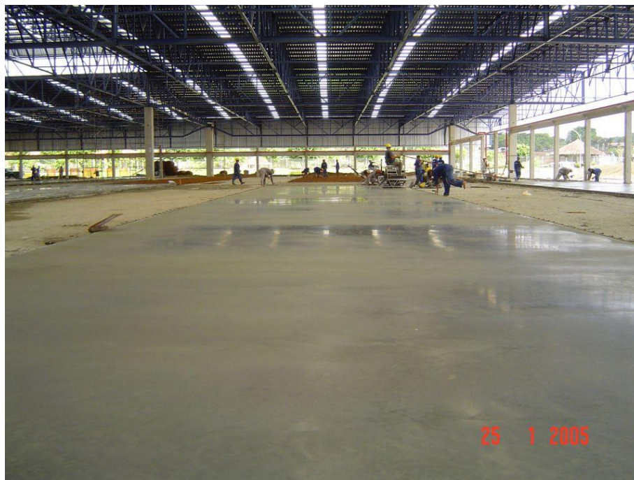
Figura 1 – Exsudação em piso de concreto armado – Cleantec - 16/03/2012
