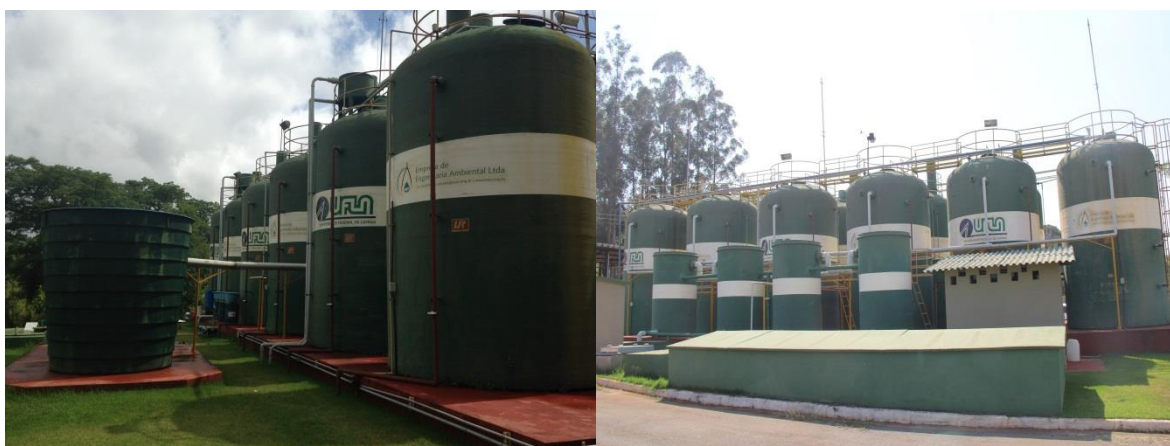
Figuras 31 e 32: Estação de tratamento de esgoto no campus
