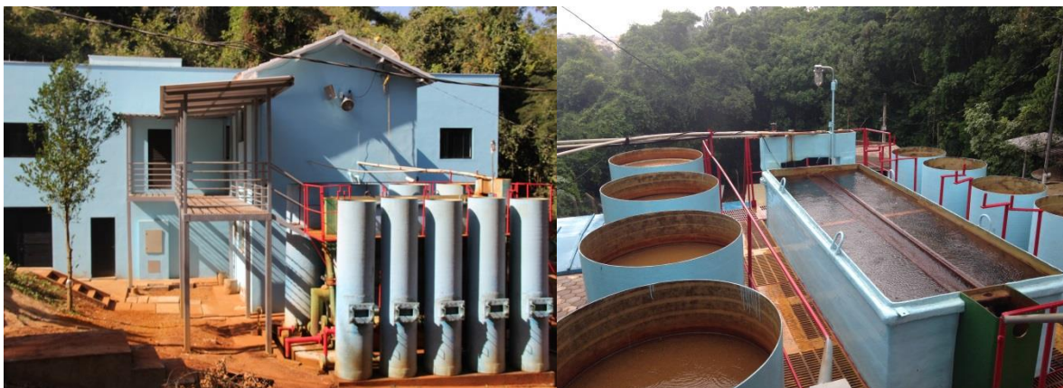
Figuras 27 e 28: Estação de Tratamento de Água no campus
