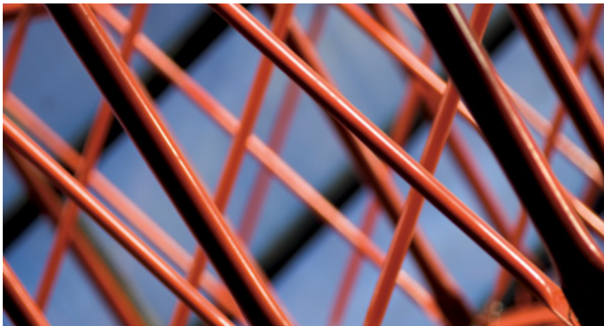
Detalhe da estrutura metálica da cúpula do Museu de Ciências e Tecnologia, de série fotográfica de 2008
