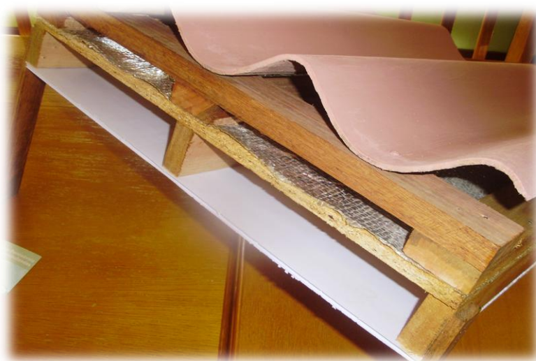
Figura 6: Colchão de ar no teto
